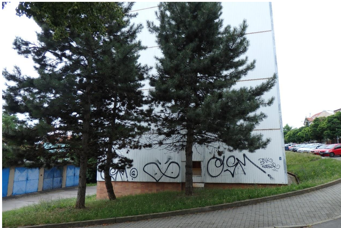
Štítová zeď sousedního bytového domu, žádoucí by byla úprava, včetně úpravy vegetace
