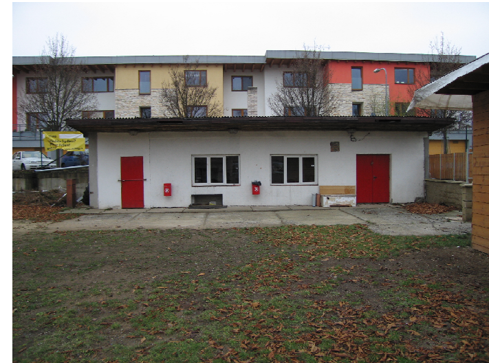
nevyhovující a nevzhledný objekt zázemí venkovního areálu Sokola
