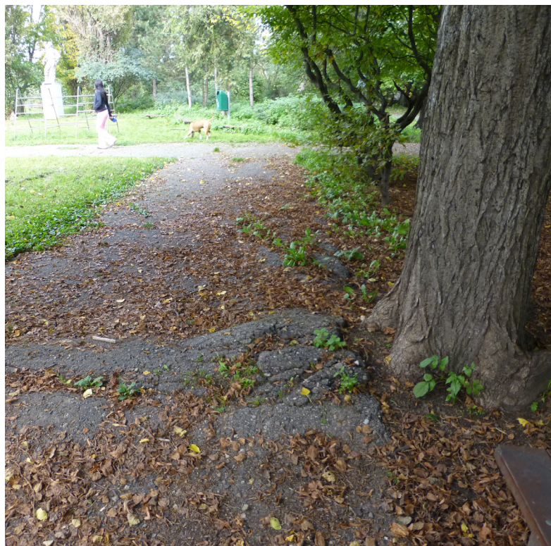
porušení asfaltových cest kořeny stromů
